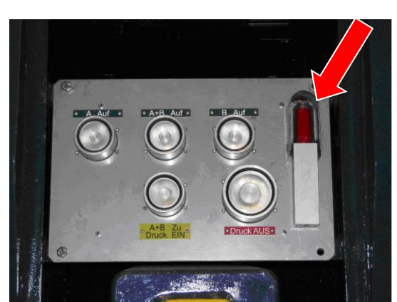
Pos. 2 – Die Anlage steht unter Druck (Anzeige ist rot)
