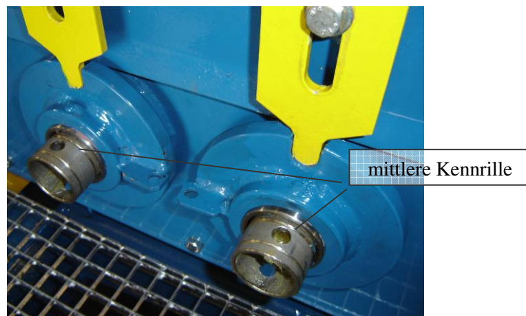
Rastrierhebeln mit Rastrierscheiben eingerastet, mittlere Kennrinne der mechanischen Anzeige sichtbar, Schieber ist geschlossen Diese Position muss vor der Beladung sowie nach der Entladung gegeben sein.
