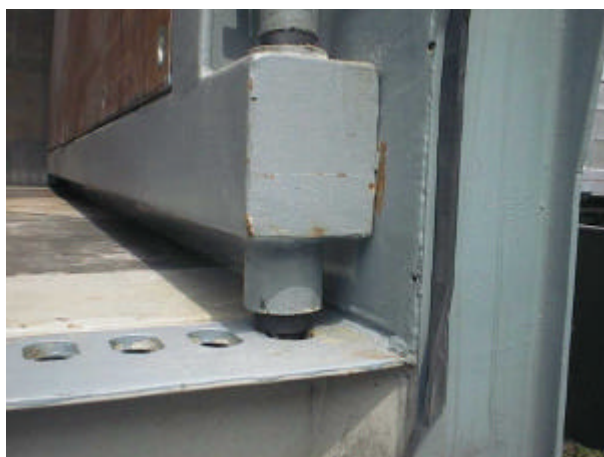
Bild 18: Verriegelungsbolzen im Fußboden
